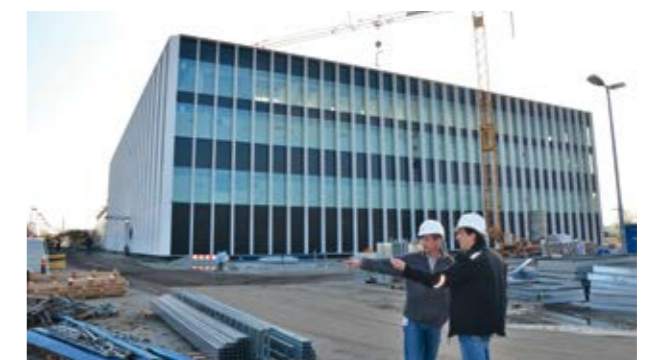
Voller Elektro-Hightech von Kreuzpointner: Das 2013 fertiggestellte Fluglotsen-Center der Deutschen Flugsicherung, das sich direkt neben dem Urlauber-Parkplatz P51 befindet, hier mit Projektleiter Fritz Rottler (re.) und Bauleiter Christian Gryt.
