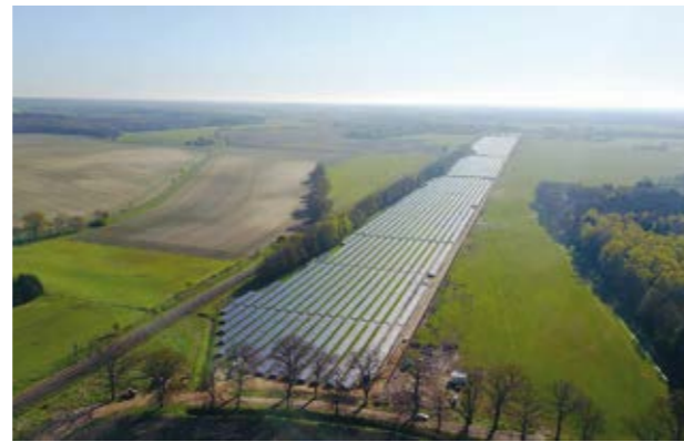
Im Februar akquiriert, im April und Mai ausgeführt: Der PV-Park Düssin mit seiner Leistung von 7,6 Megawatt befindet sich an der Bahnstrecke zwischen Hamburg und Berlin. (Foto: Solar-Konzept GmbH)
