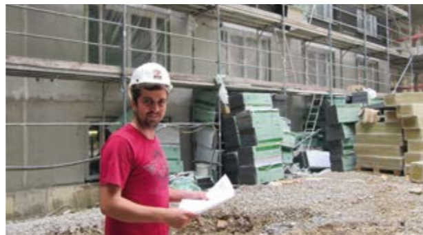
Obermonteur Florian Flickinger auf der Baustelle des neuen Großprojekts Seniorenresidenz (Visualisierung) in der Münchner Einsteinstraße.
